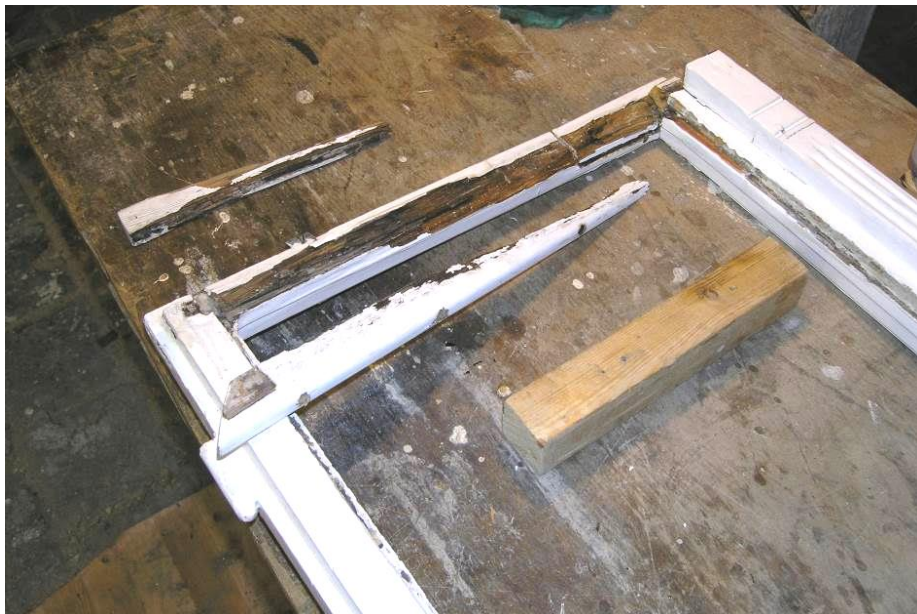
Obr. 3 Příklad okenního rámu, jehož spodní část je v důsledku poškození sklenářského tmelu silně napadena hnilobou. (foto Matěj Boháč)
