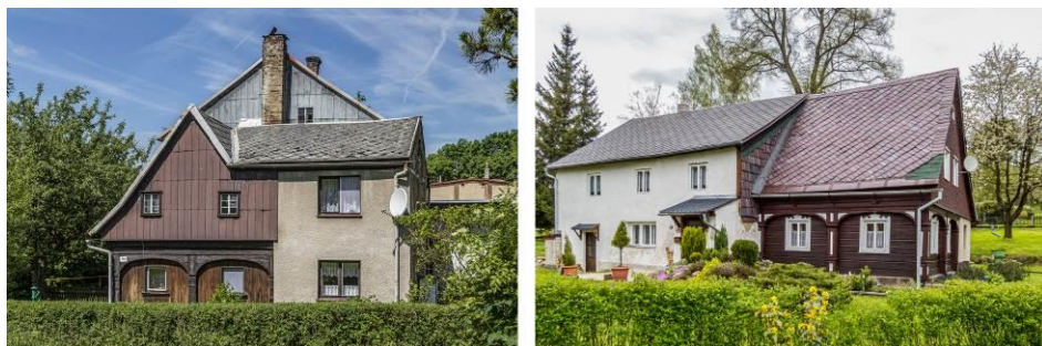
Obr. 4.: Příklady soudobých intervencí u podstávkového domu – nástavby Vlevo – příklad necitlivé intervence – Mikulášovice č.p. 104 /Šluknovsko/ Vpravo – příklad necitlivé intervence – Mikulášovice č.p. 470 /Šluknovsko/ (foto S. Kutílková; 2017)
