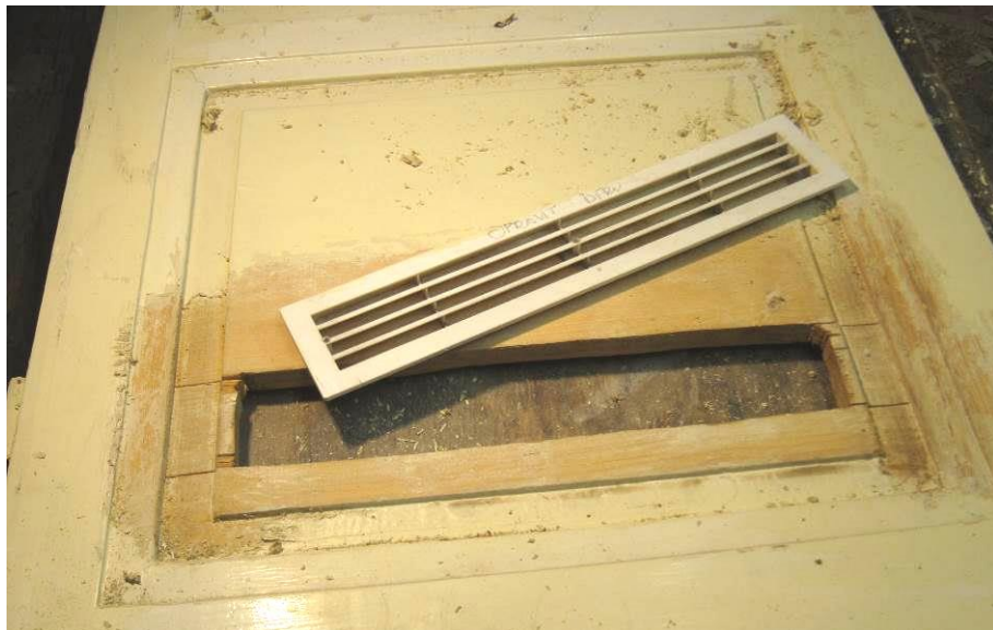
Obr. 6 Neodborně osazená větrací mřížka ve výplni dveří. (foto Matěj Boháč)
