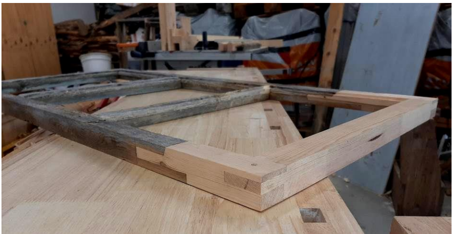
Obr. 5 Jiný příklad lokálního protézování okenního rámu. (foto Matěj Boháč)
